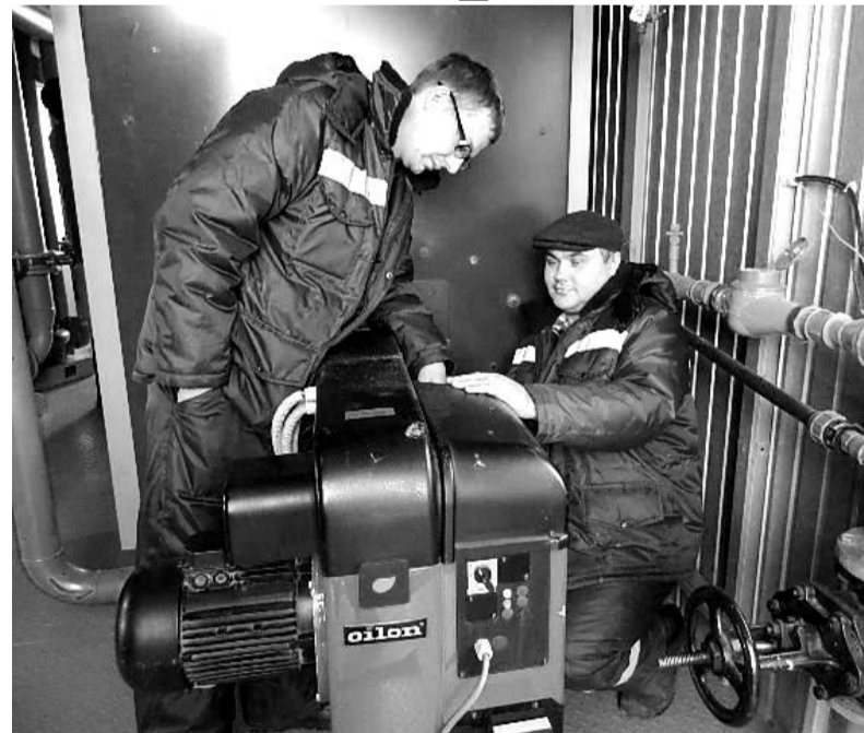
Осмотр вентилятора газовой горелки в модульной котельной №1 проводят А. Шалыев и К. Пурдышев.
